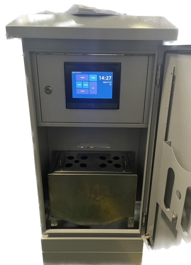
图 2：箱式岸边站主体内景
