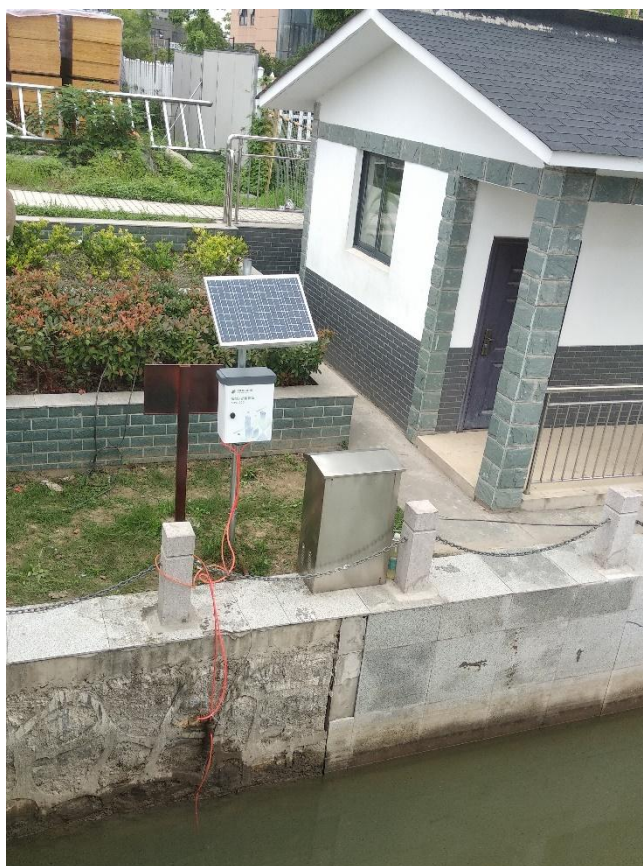
图 5：杭州市某河道断面微型站
